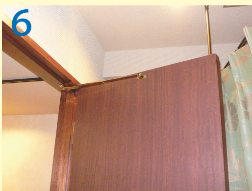
6 更衣室とスタッフルームのカーテンレールがぶつかってしまった。
